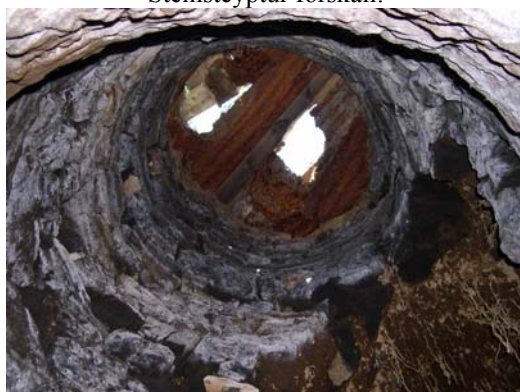
Hrun í strompi. Dökki flöturinn neðst til hægri.
